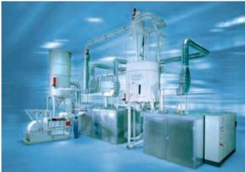
带封闭防护的完整的植物纤维粉磨生产线
