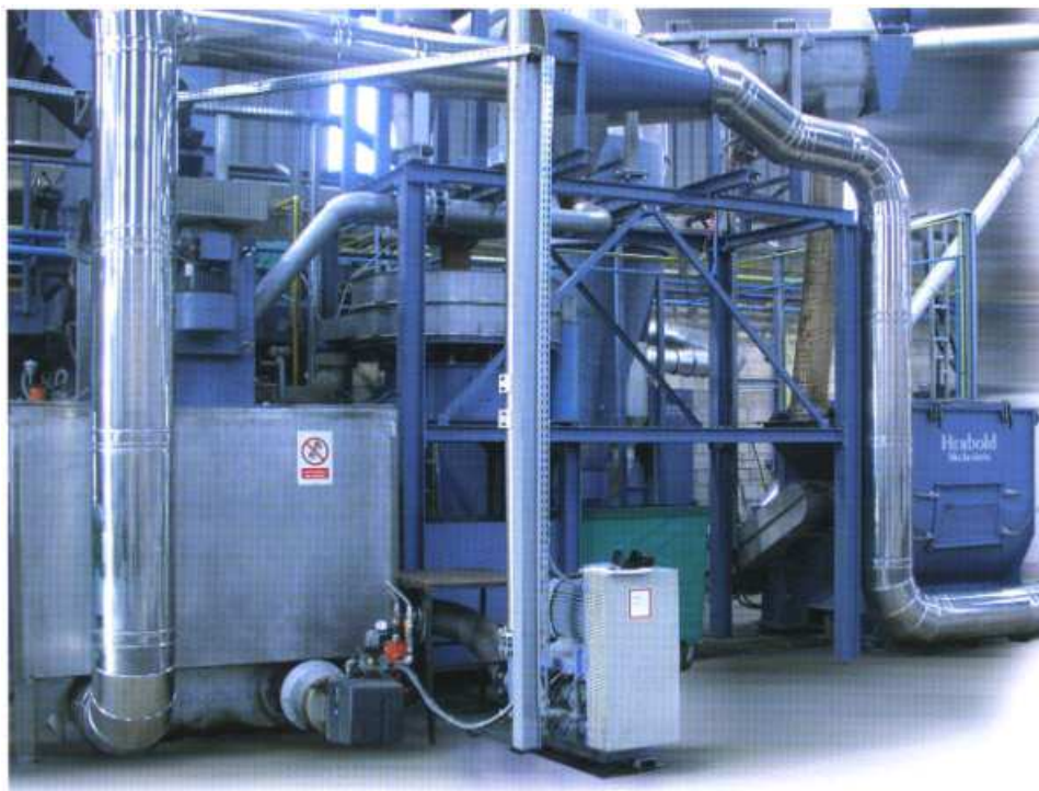
Unité de lavage à chaud
